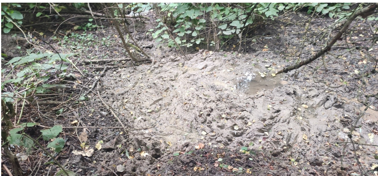
Fot. 2. Wysięki i wypływy z skarpy bocznej powodujące uwodnienie materiału koluwalnego.
